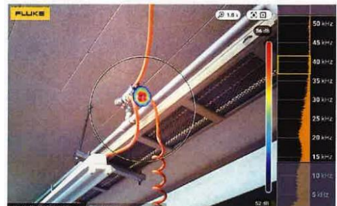
(超音波カメラを用いてエア漏れ箇所(中央赤色部分)を検出)
