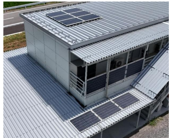
岡山作業所に設置した太陽光パネル
